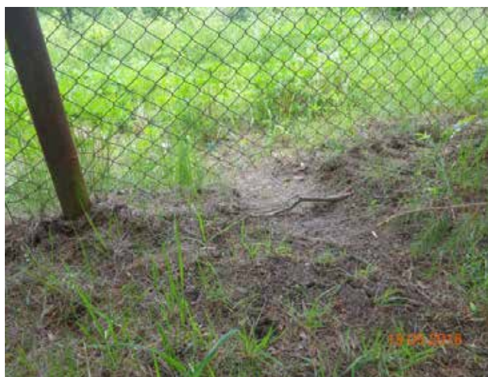
Fot. 71. Uszkodzone ogrodzenie w sadzie owocowym, fot. Bogumił Markuszewski
